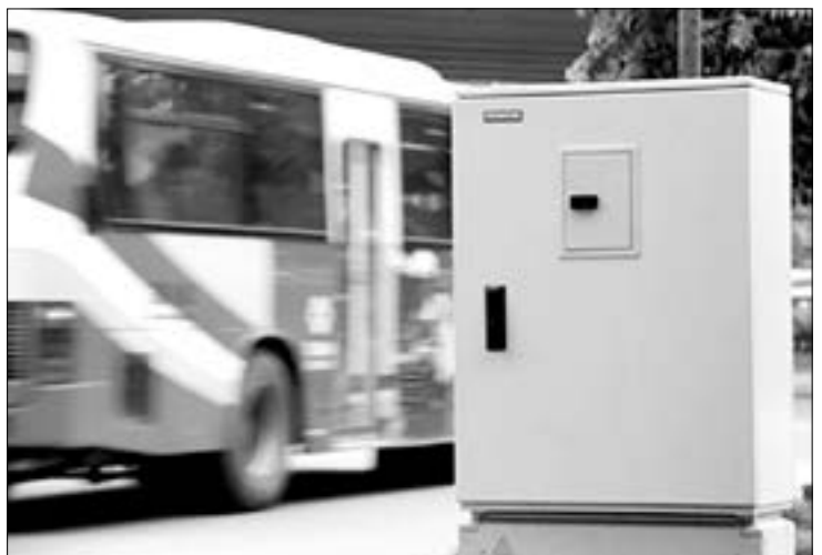
▲ Tủ điều khiển tín hiệu giao thông của hãng Siemens lắp đặt
